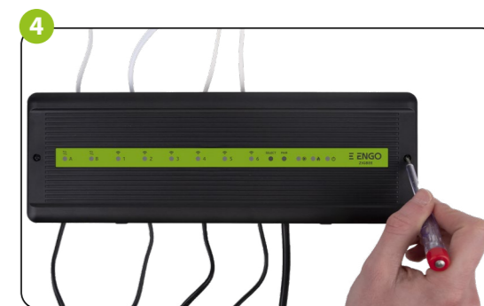
Po upewnieniu się, że wszystkie przewody są prawidłowo podłączone, zamontuj górną pokrywkę i włącz listwę do zasilania 230 V - zapali się czerwona dioda „Power”.
